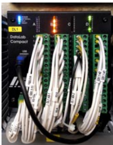
Obr 5: Jednotka DataLab Compact zabere jen málo prostoru.
