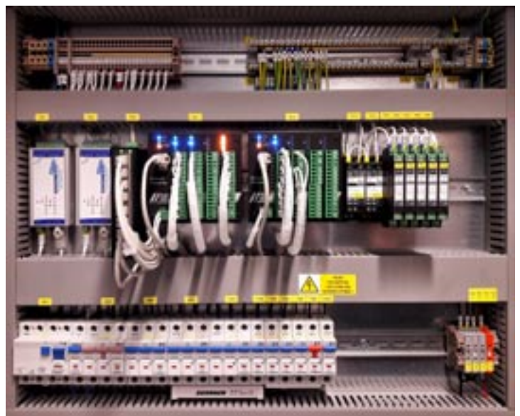
Obr 3: Automatizační rozvaděč lze díky jednotkám DataLab připojit do počítačové sítě
